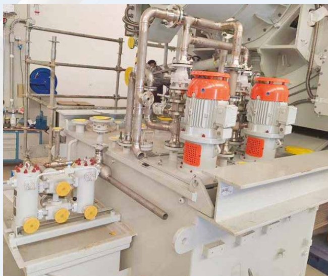
Bombas NOTOS® 3NS33/80S4I instaladas em um taque para lubrificação de mancal de compressores
