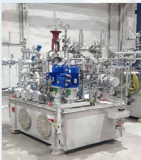
Sistema com Bombas NOTOS® 3NS147/80L7I instaladas em tanque para lubrificação dos mancais de compressores
